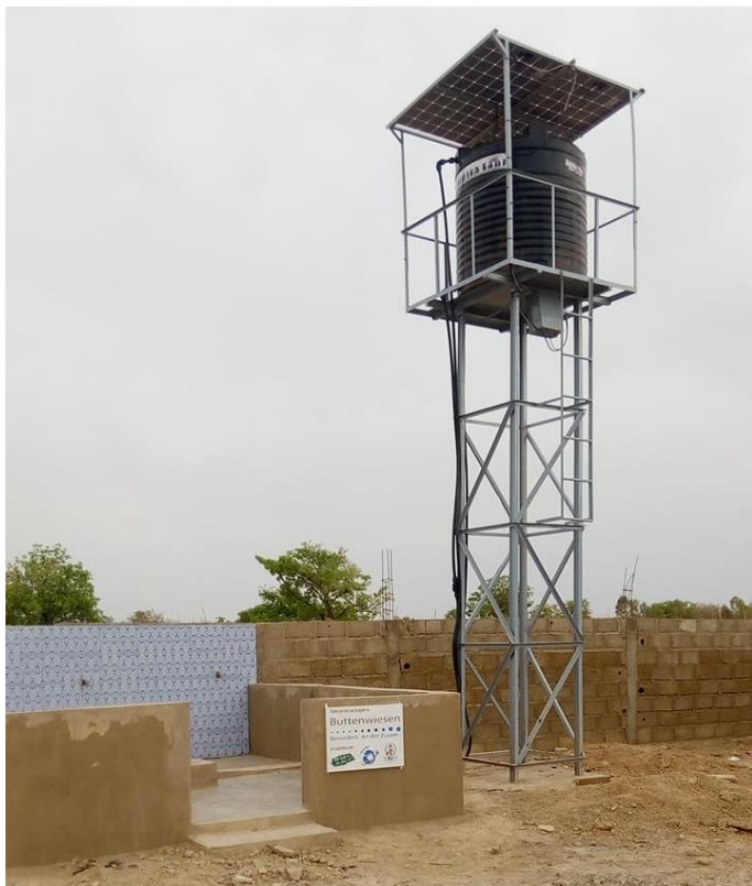
Die neue Wasseraufbereitungsanlage
